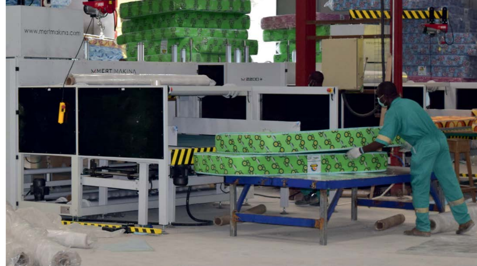
Referenz: Mouka in Nigeria – Mouka Ltd., Hersteller Erhöhte Sicherheit für Hunderte von Mitarbeitern durch Brand- und Rauchererkennung innerhalb weniger Sekunden
